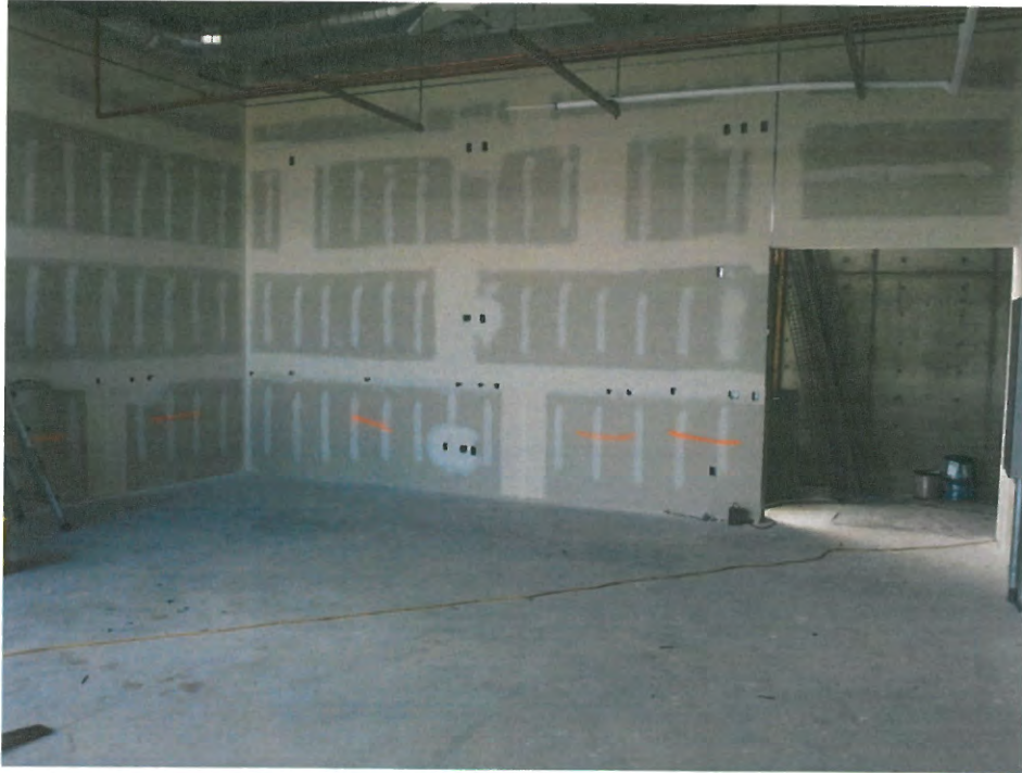
AV Wall – Flex Lab, First Floor
